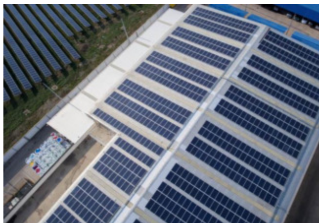
Figura 8.6 Vista de Sistema FV.
