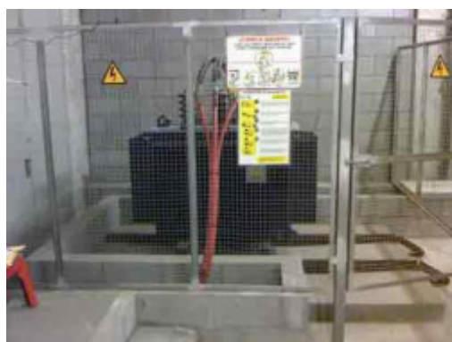
Figura 8.4 Vista de Cámara Transformadora.
