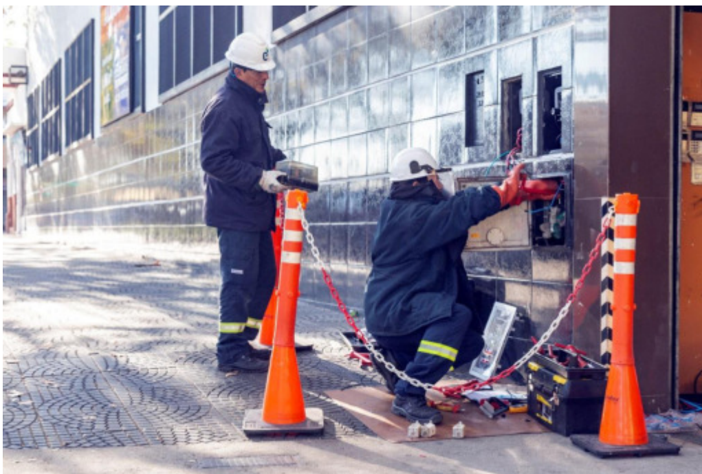
Figura 5.15 Instalación de medidor bidireccional
