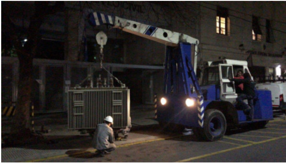
Figura 8.3 Instalación de Cámara Transformadora.
