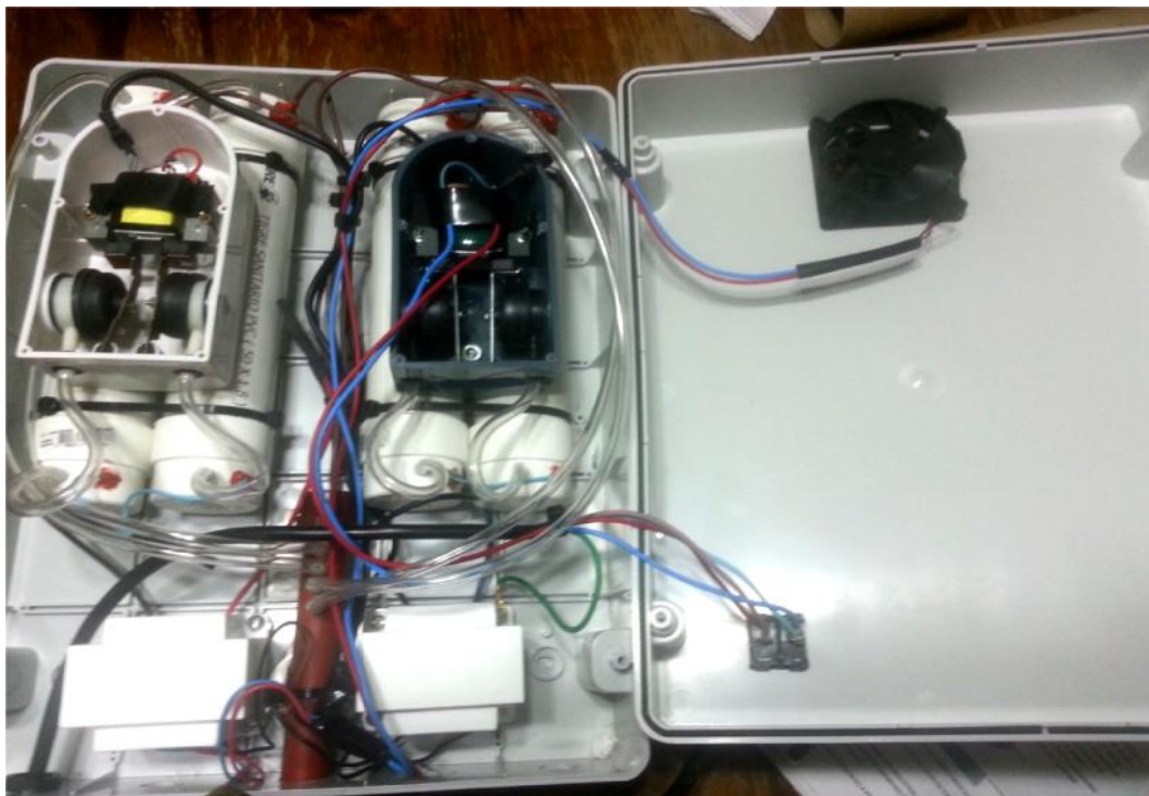
Figura 4: Vista interna del generador de ozono
