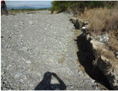
Foto N° 19: Tramo Suroeste que ya sufrió inundaciones años anteriores.
