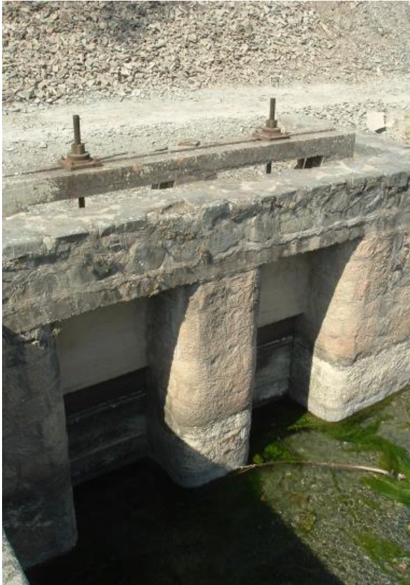
Foto N° 3: Derivadores en la estructura del dique La Higuera. Valle de Choromoro. Trancas. Tucumán. Fuente: Producción propia del autor.
