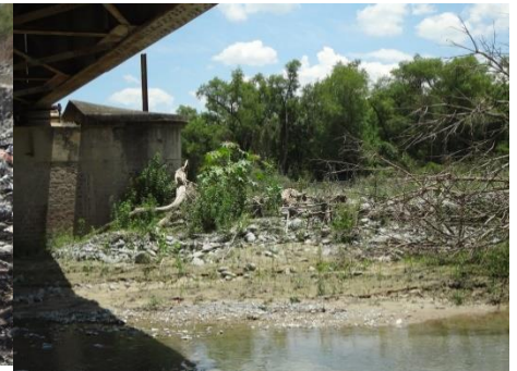
Foto N° 24: Zona erosionada en puente ferroviario.
