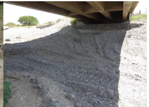
Foto N° 27: Zona Noroeste del puente carretero, con extracción de áridos.
