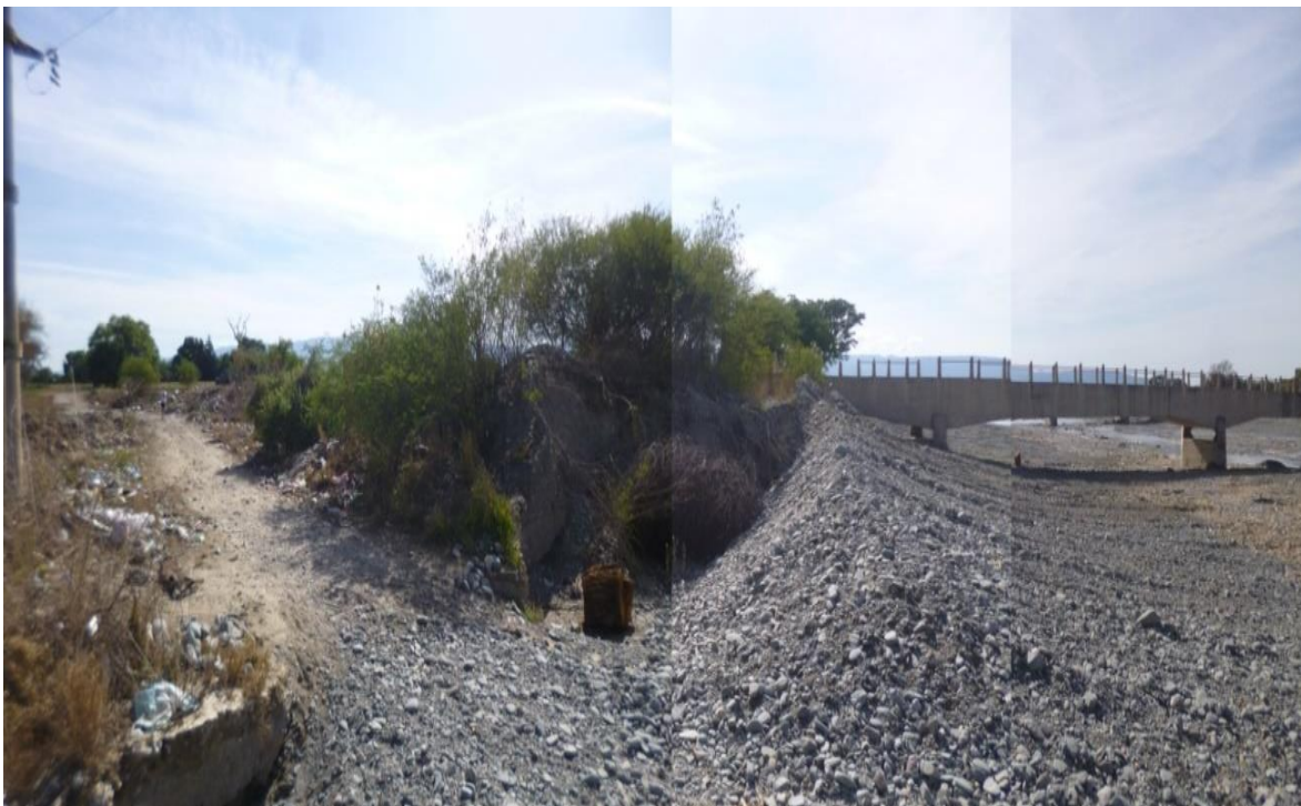
Foto N° 16: Vista de la zona central del puente con observación marcada de extracción de áridos. Río Choromoro. Trancas. Tucumán. Fuente: Producción propia del autor.
