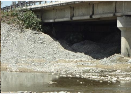
Foto N° 20: Zona erosionada debajo de la Ruta Nacional N° 9.
