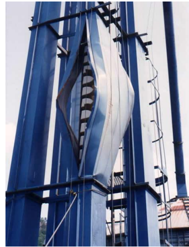
Fig.3-9. Falta panel de venteo
