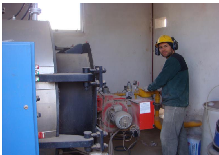
Fig. 2-23. Sala de caldera.
