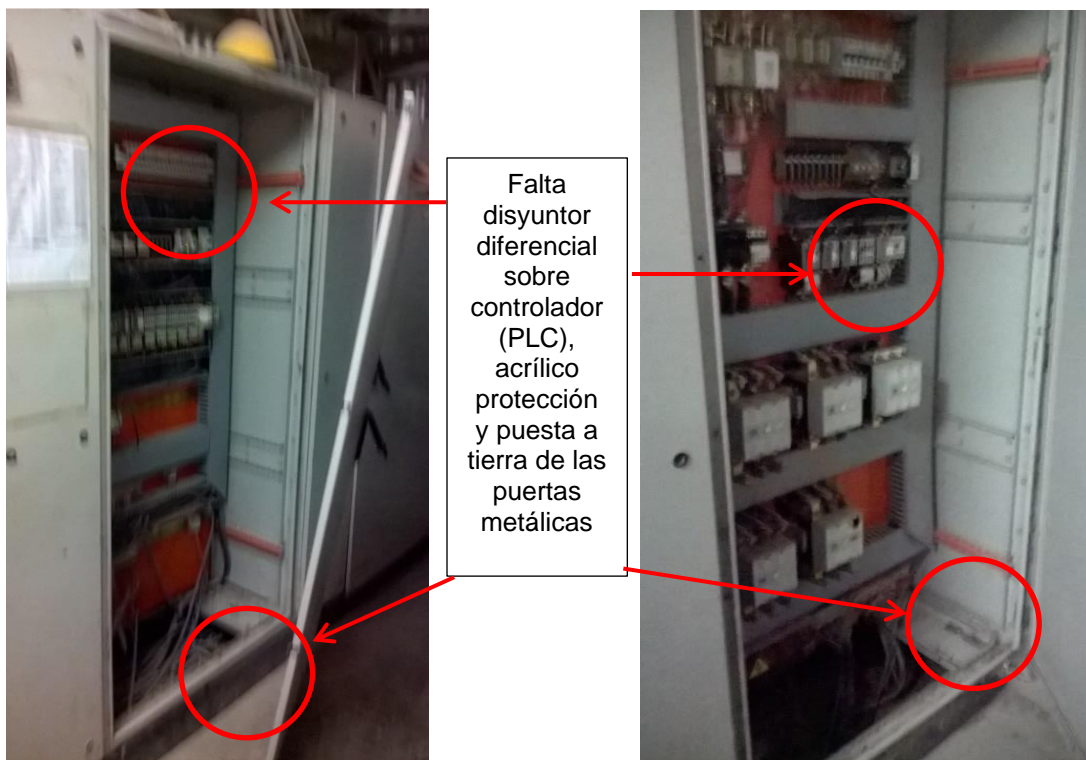
Fig.3-47. Tableros principales (T.P) del proceso de molienda y mezclado.
