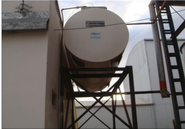
Fig. 1-43. Tanque de reserva agua potable
