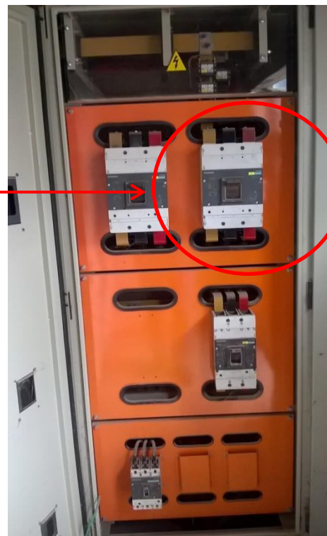
Fig.3-45. Tablero baja tensión
