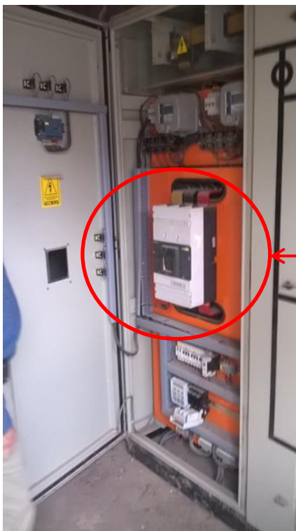
Fig. 3-44. Seccionador principal media tensión
