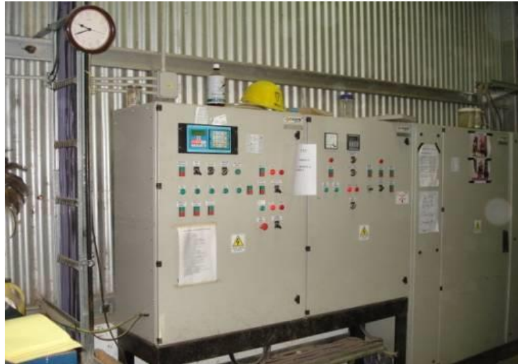
Fig. 1-38. Tablero de molienda y mezclado sala de control
