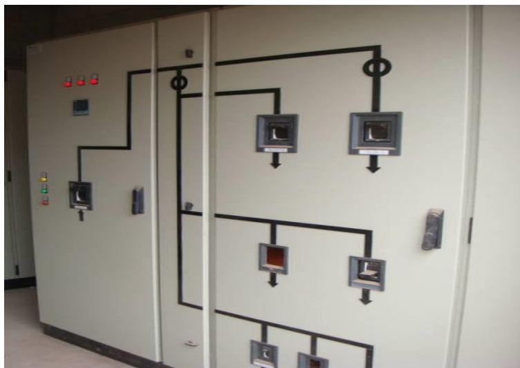
Fig. 1-37. Tablero General de Baja Tensión
