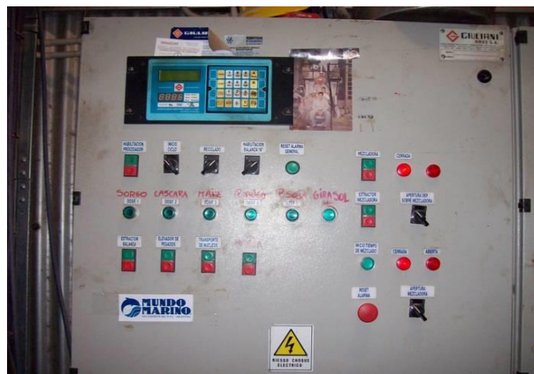
Fig. 1-19. PLC controlador del proceso
