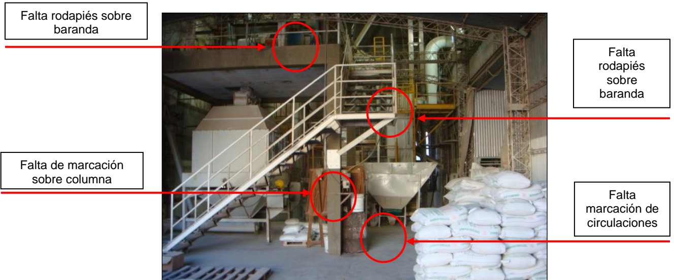
Fig. 2-18. Vista Interior sector Pelleteado y Enfriador de Flujo
