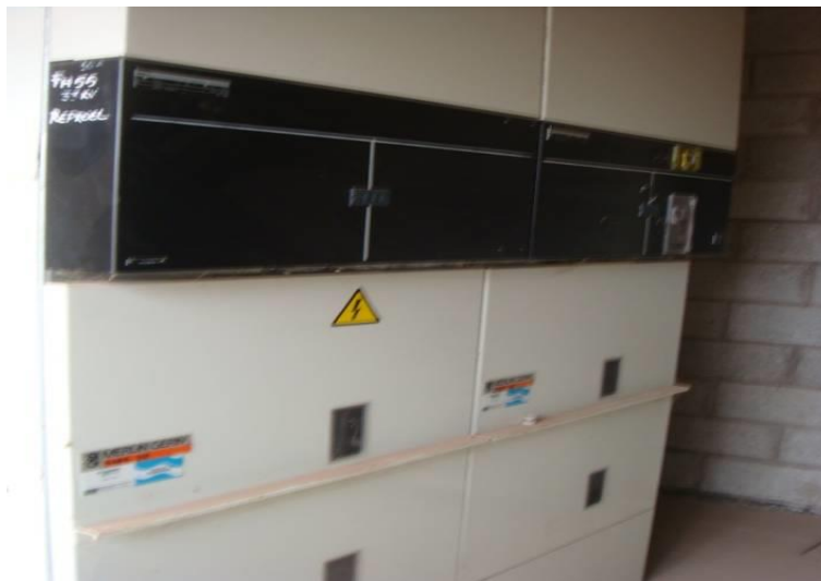
Fig. 1-36. Celda de Media Tensión
