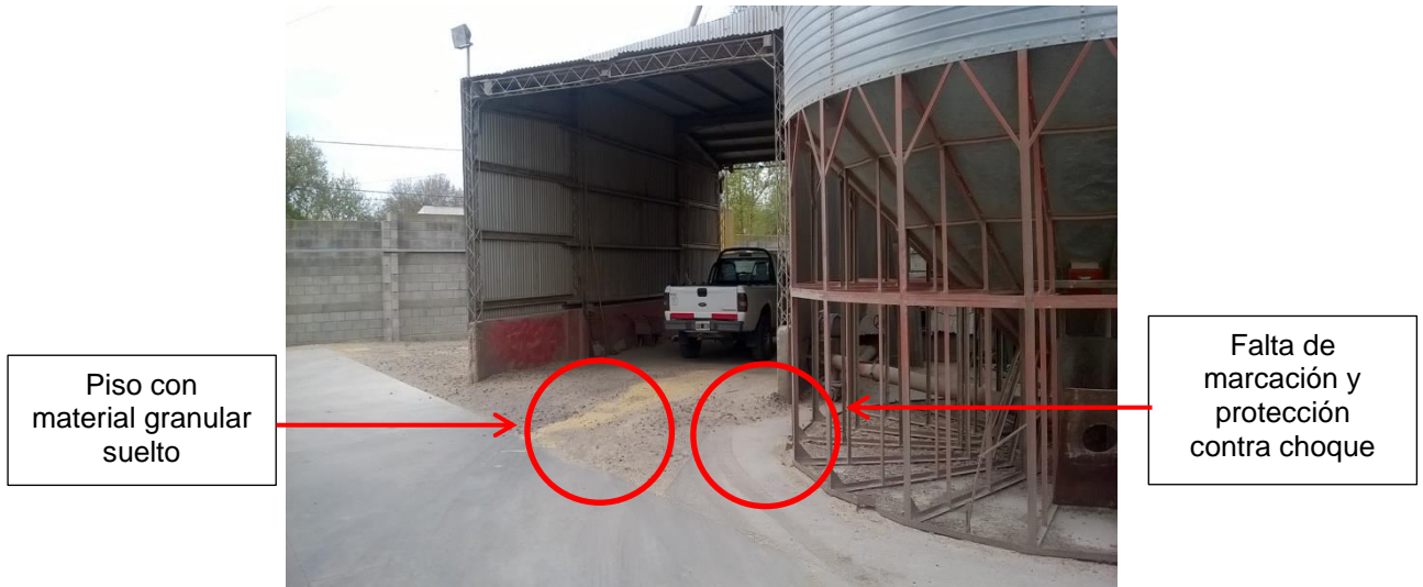
Fig. 3-29. Sector silos aéreos sector de descarga a granel
