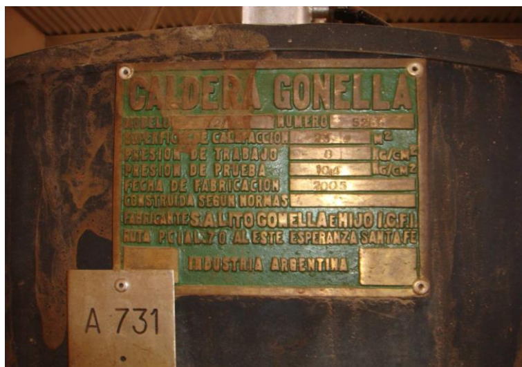
Fig. 1-40. Placa de la caldera
