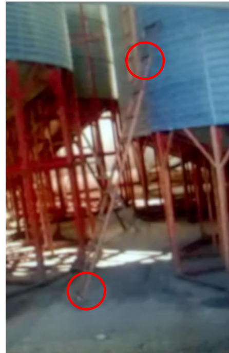
Fig.3-55 Sector acopio silos aéreos
