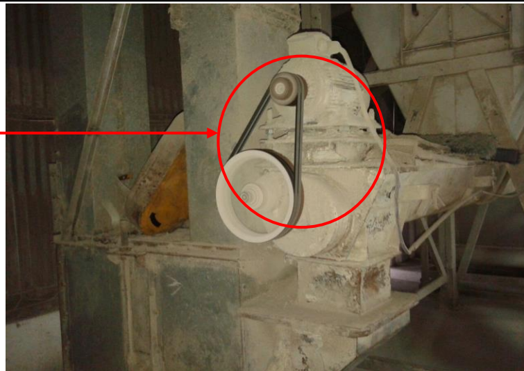
Fig. 2-14. Motor cangilones sin protección
