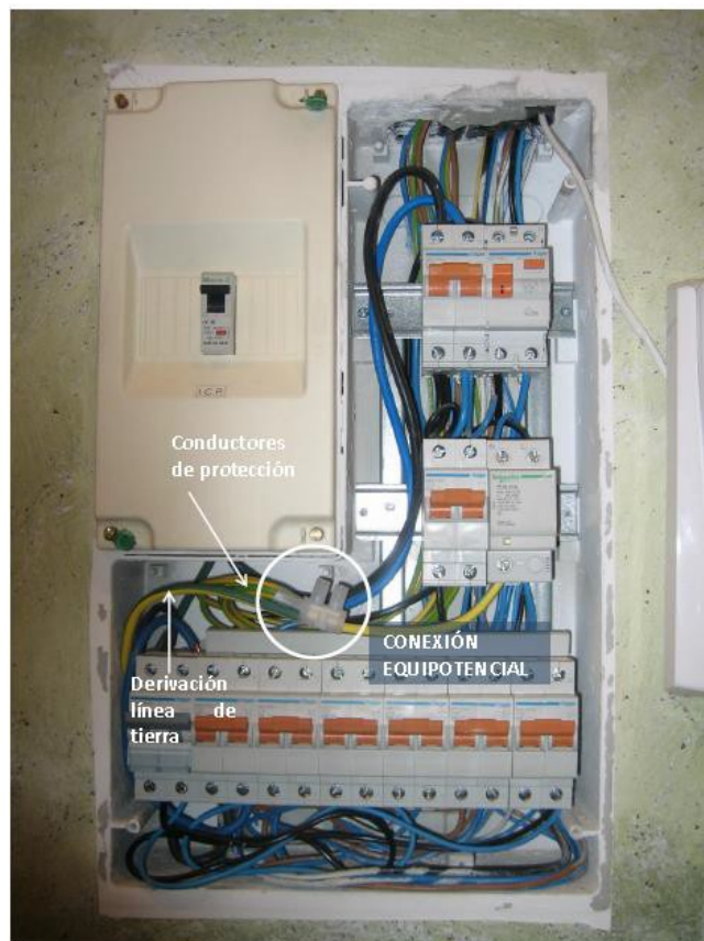
Fig. 7-12 Fotografía del cuadro eléctrico de una vivienda construida en el 2013. [L-12]
