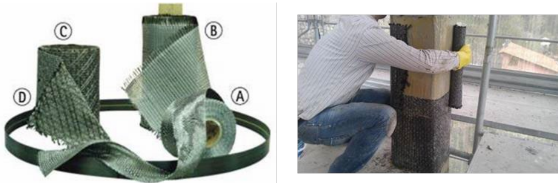
Fig. 2-40 Fibras de carbono y reparación de una columna de hormigón. [D-40]
