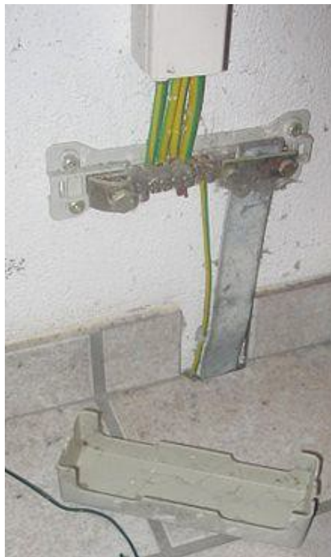
Fig. 6-12 Conexión equipotencial a una barra a tierra. [K-12]
