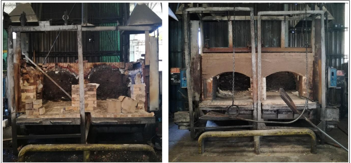
Figura 3.5: Mantenimiento de hornos a gas.
