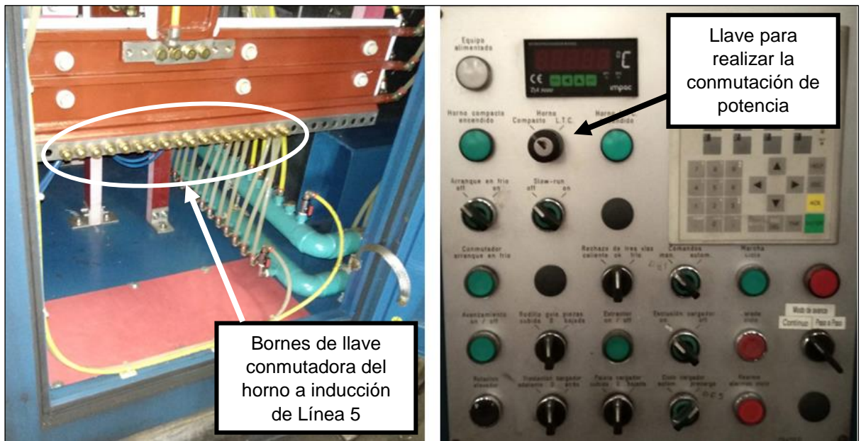
Figura 5.7: Bornes y llave de conmutación del horno a inducción de L5
