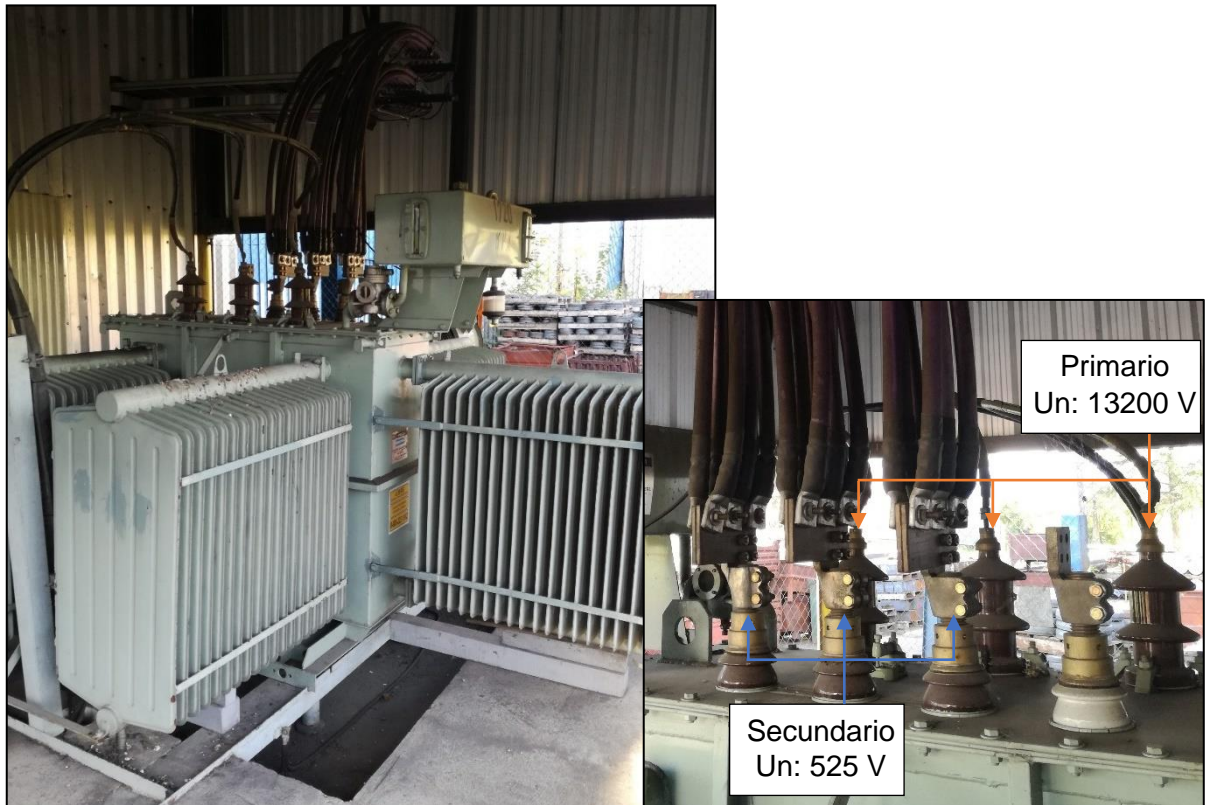
Figura 5.3: Transformador 13,2 kV a 525 V
