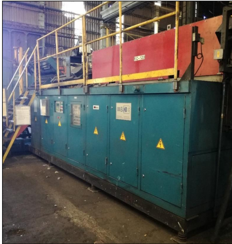
Figura 5.6: Horno a inducción presente en la línea 5
