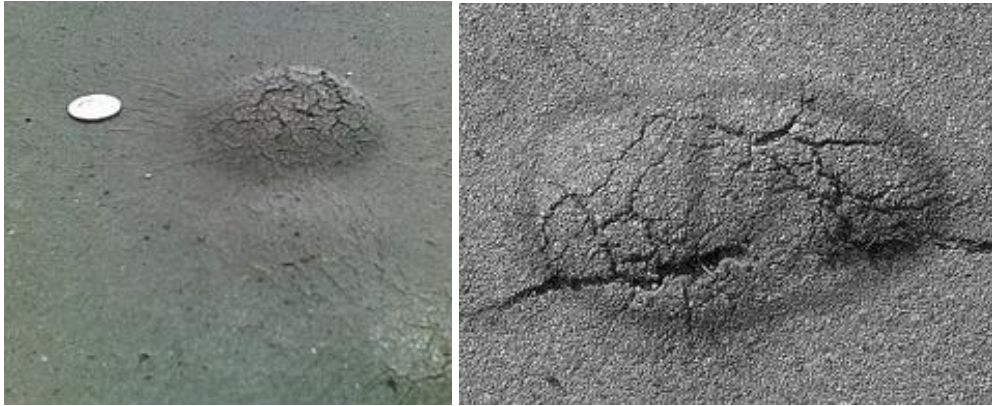
Figura 2-21. Deterioro de la capa superficial por ampollas Fuente: Bianchetto, 2012
