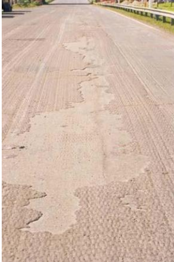
Figura 2-24. Descascaramiento por bajo espesor remanente Fuente: Bonfim, 2008
