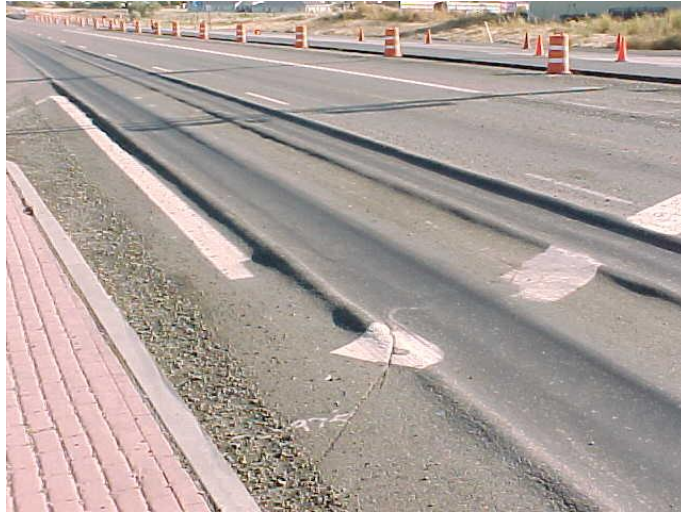
Figura 2-20. Pavimento ahuellado por inadecuada mezcla asfáltica Fuente: www.pavementinteractive.org
