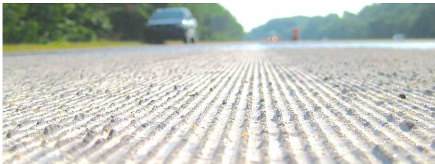
Figura 2-5. Textura generada por el fresado del pavimento Fuente: www.thetranstecgroup.com
