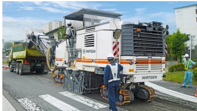
Figura 2-18. Fresado de pavimento con fisuras
