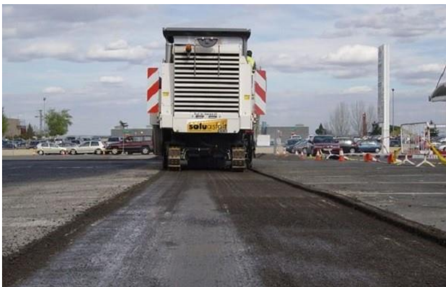
Figura 2-7. Obra con baja textura de fresado Fuente: durangopress.com
