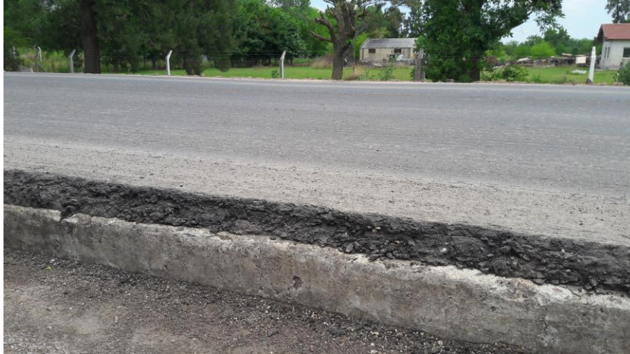
Figura 7-4. Vista lateral del espesor remanente de mezcla asfáltica Fuente: elaboración propia
