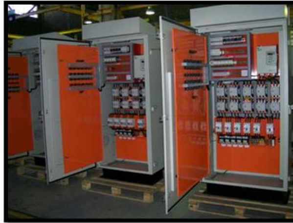
Figura 12-1: Tablero eléctrico industrial WEG
