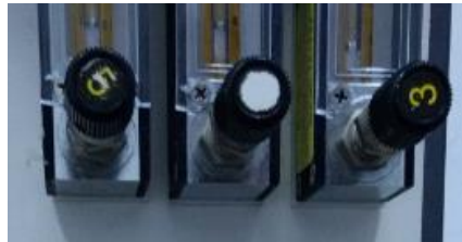
Imagen MC-5: Válvulas aguja de los caudalímetros.
