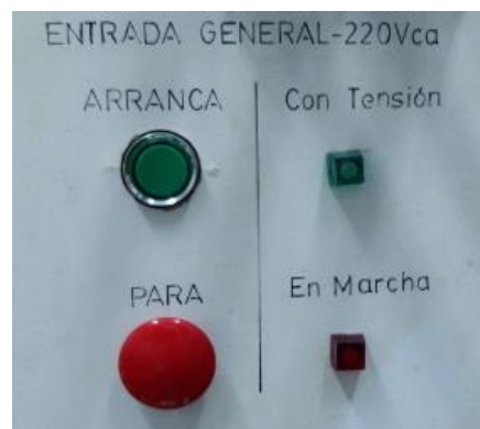
Imagen MC-6: Interruptores de marcha y pare.
