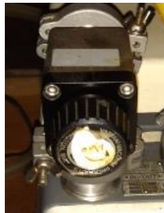
Imagen MC-8: Válvula de la bomba de vacío.
