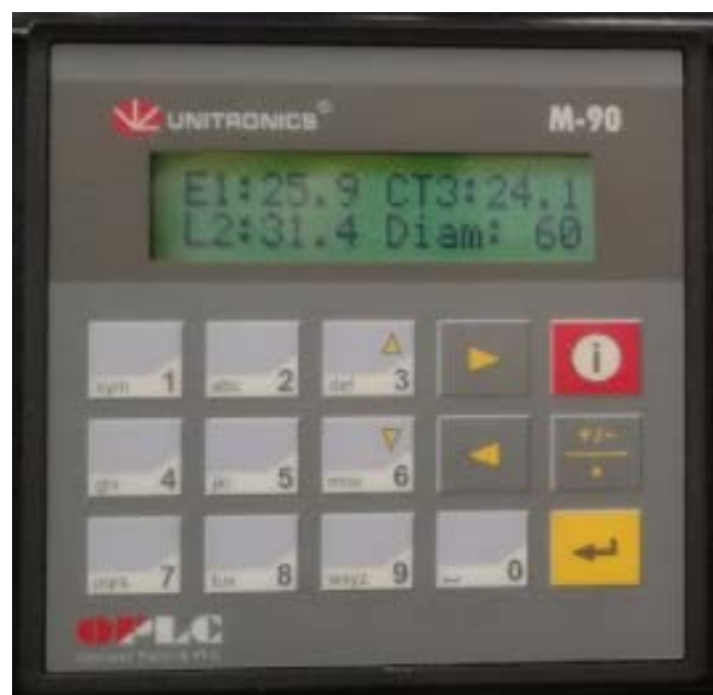
Fig. 26 – Pantalla Inicial del PLC
