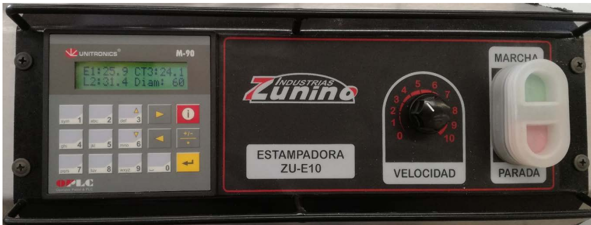
Fig. 4 – PLC y Panel de Control
