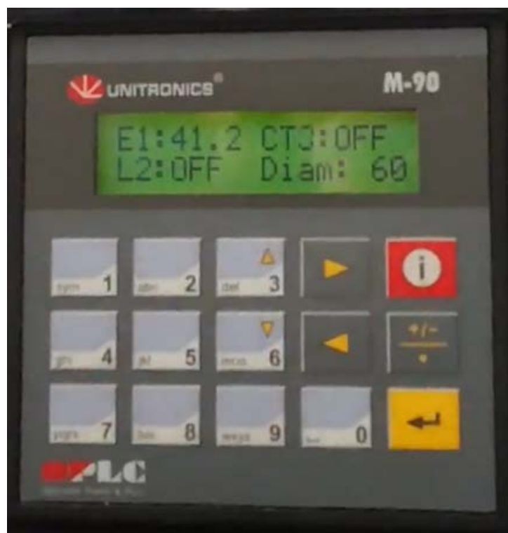
Fig. 28 – Pantalla para mostrar motores apagados o manual
