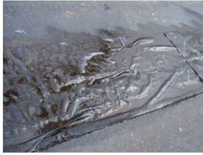
Figura A.10 Material defectuosamente colocado
