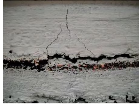
Figura VII.50 Propagación de fisura con interposición de Arena asfalto
