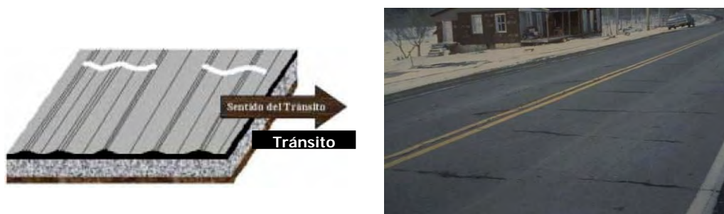
Figura II.11 Falla del tipo corrugación
