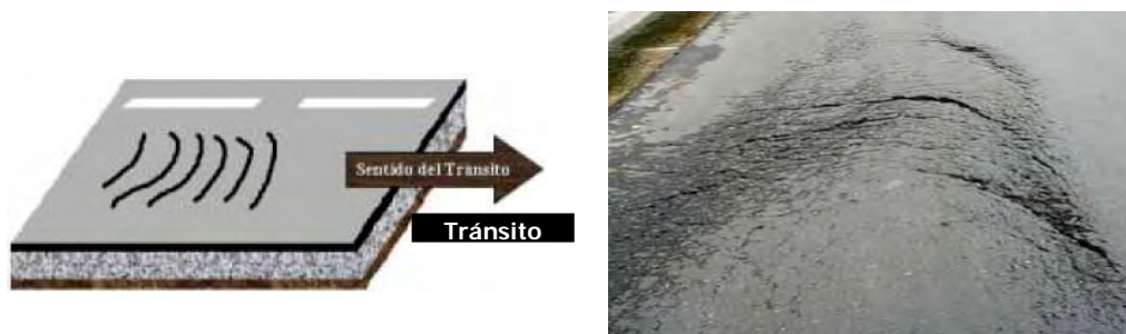
Figura II.10 Falla del tipo fisuras en arco o media luna
