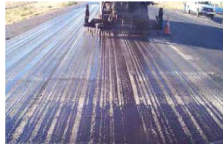
Figura IV.18 Ejecución del riego en forma incorrecta
