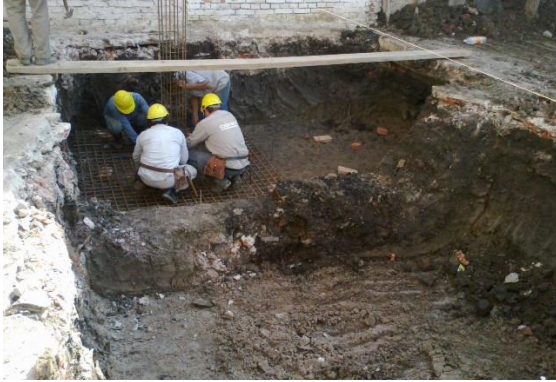
Caída distinto nivel: excavación zapata.
