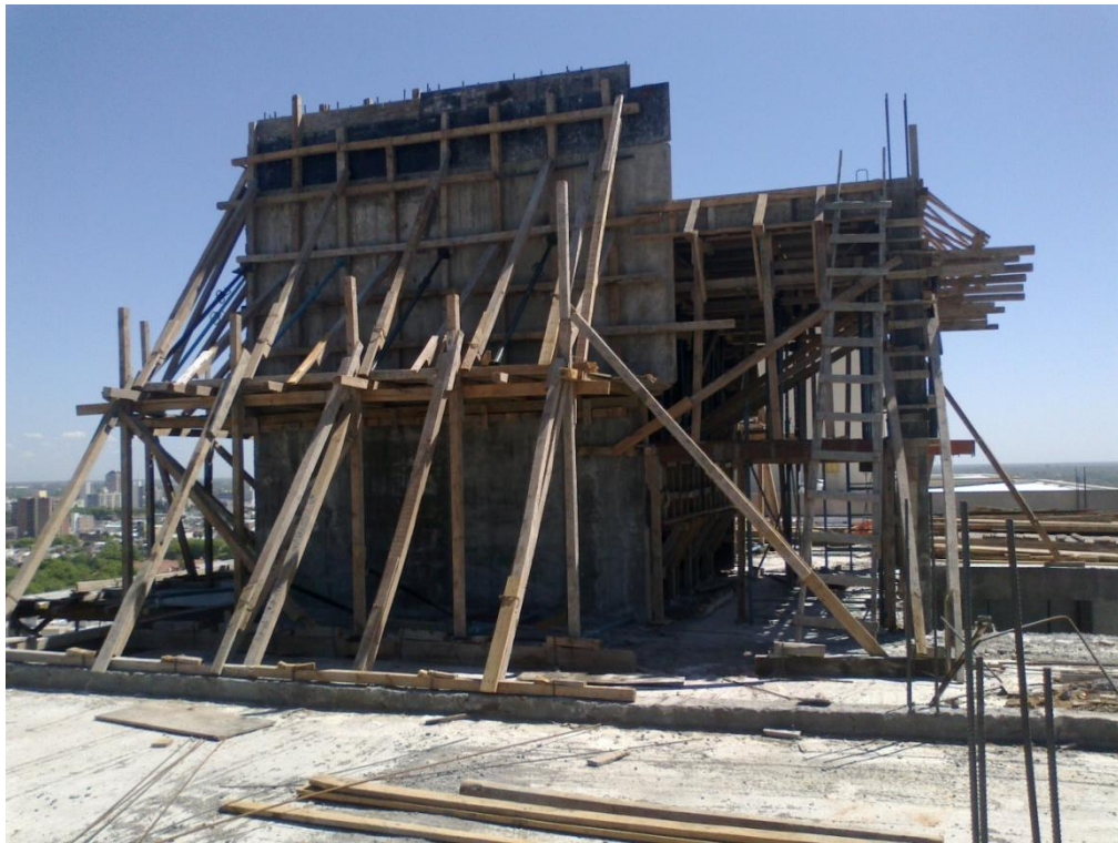
Apuntalamiento del tabique de ascensores y tanque de agua en la parte superior.
