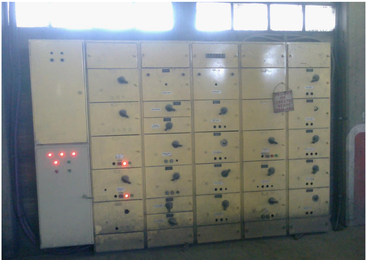
Fig. 26: Tablero seccional servicios auxiliares 4to piso.
