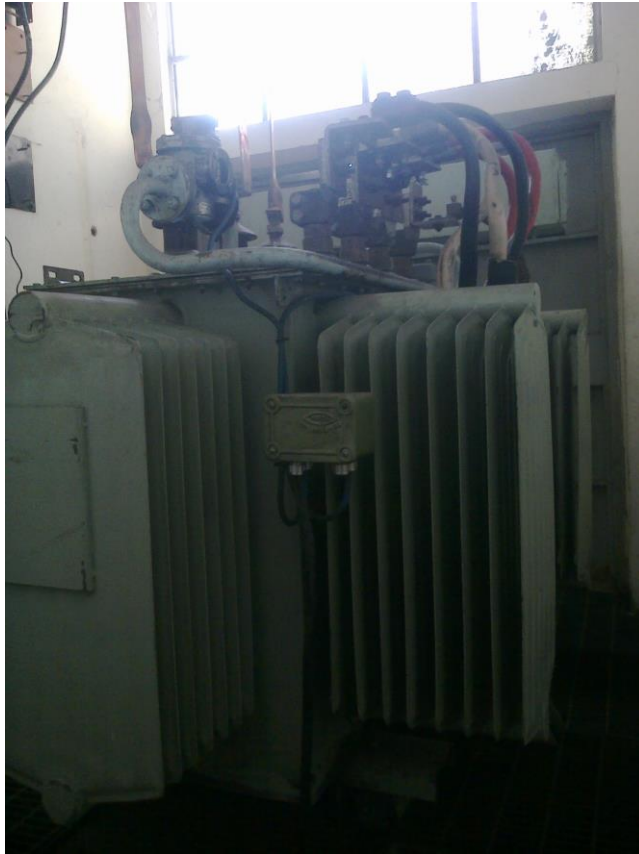
Fig 20: Transformador T8 de 800kVA (serv. Aux.).
