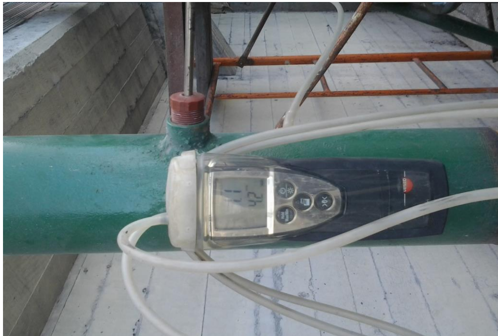
Fig. 36: Medidor de velocidad (m/s) mediante tubo de pitot.
