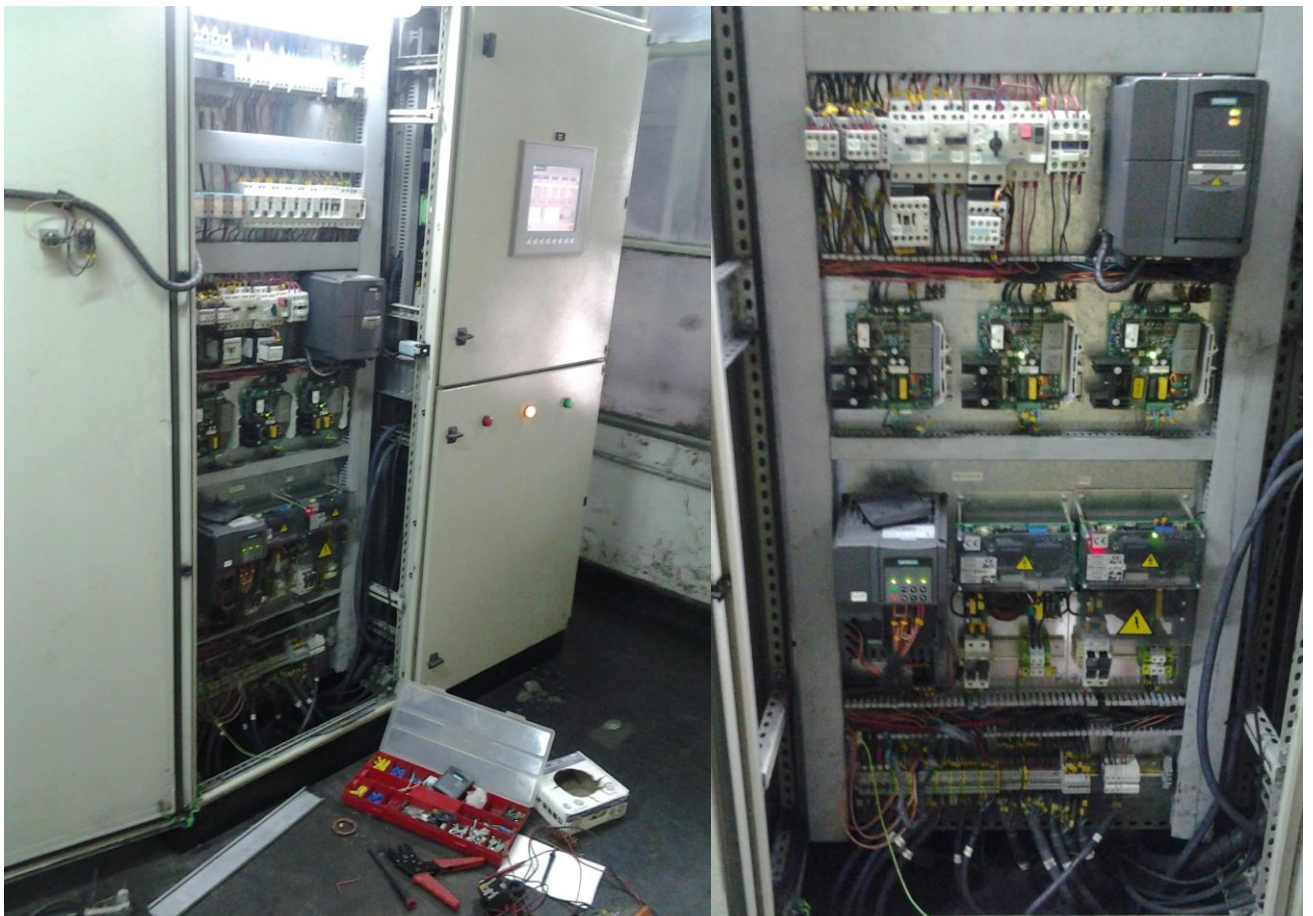
Fig.64: Fotografía del variador de velocidad durante su conexión.
