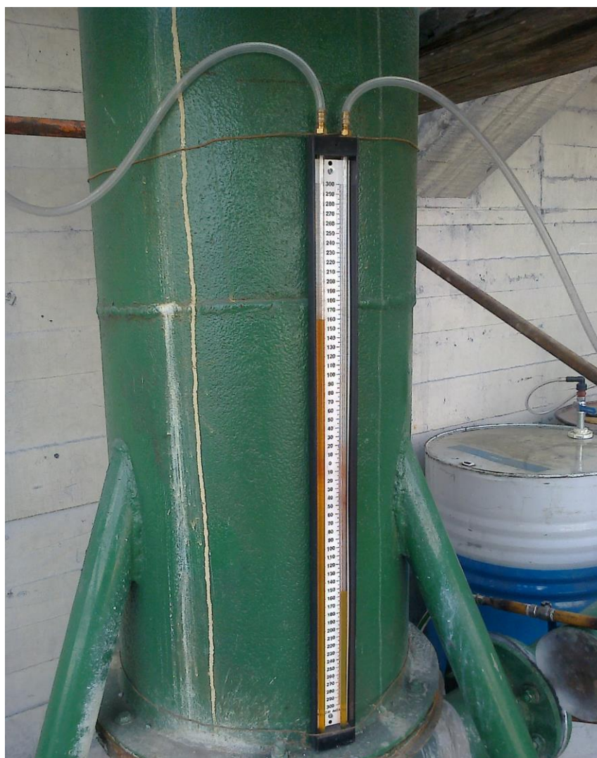
Fig. 33: Manómetro diferencial para medición de presiones en filtro. Lectura de fotografía, en etapa final del ensayo.
