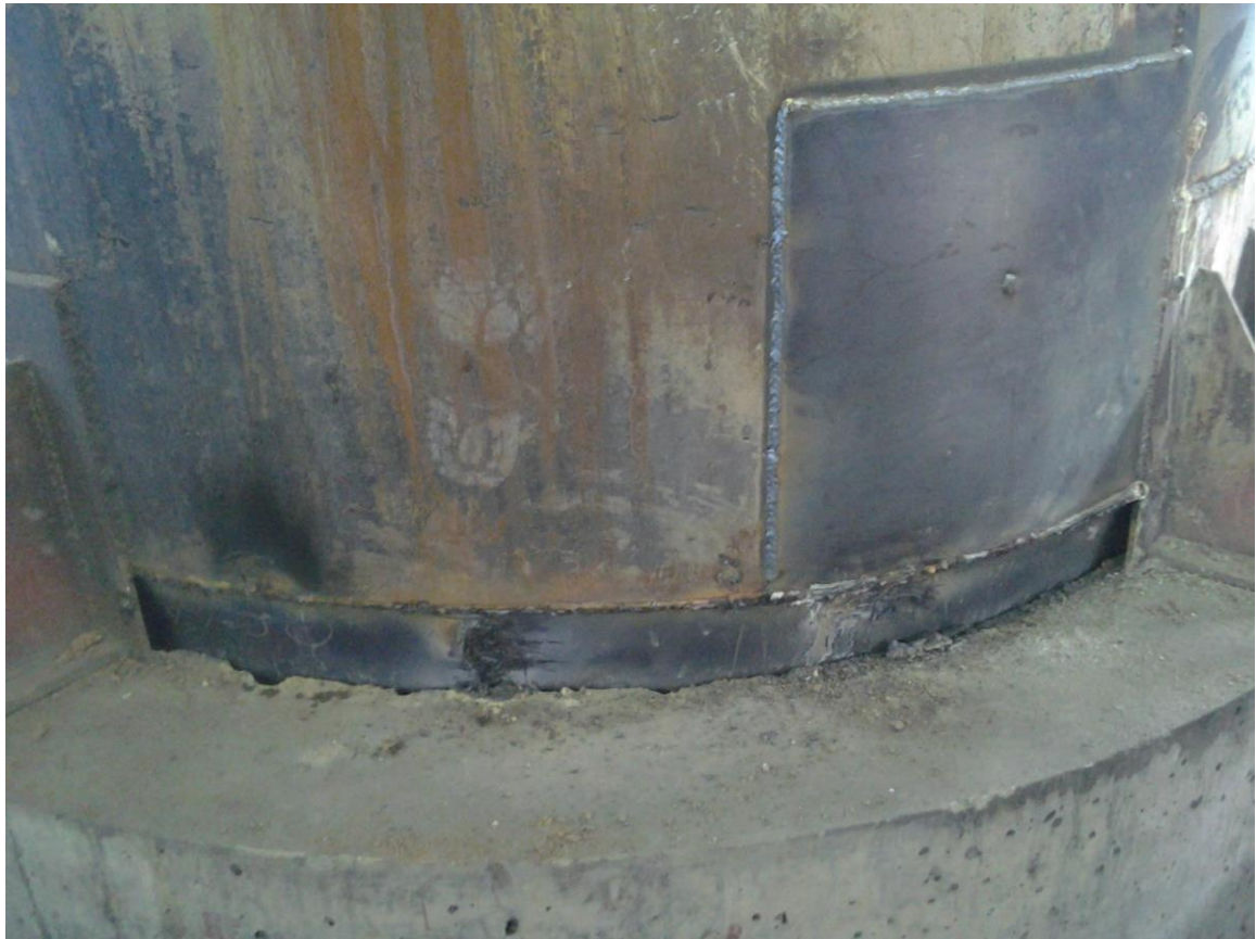
Fig. 49: Cuerpo ciclón con reparación de parte deteriorada por la corrosión.
