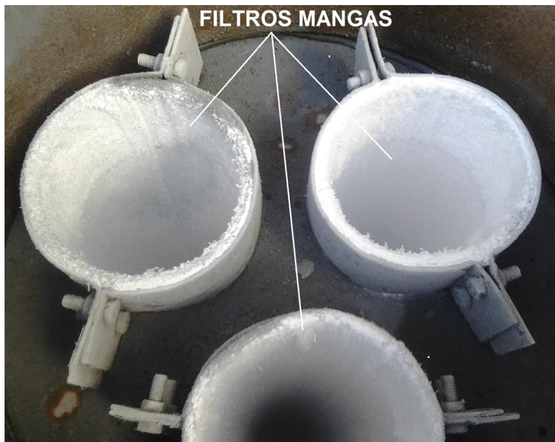
Fig. 34: Cámara superior del filtro, mangas filtrante con deposición de sólidos.
