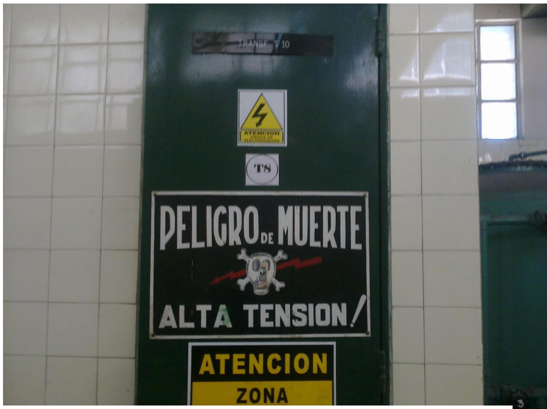
Fig 22: Puerta de ingreso a sector de transformador servicios auxiliares T8.
