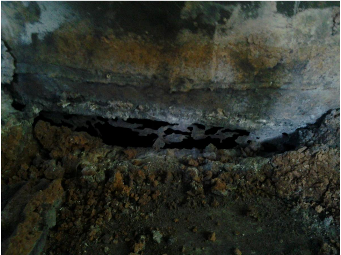
Fig. 47: Unión entre la parte cilíndrica superior y el cono del ciclón. Observar grave corrosión.
