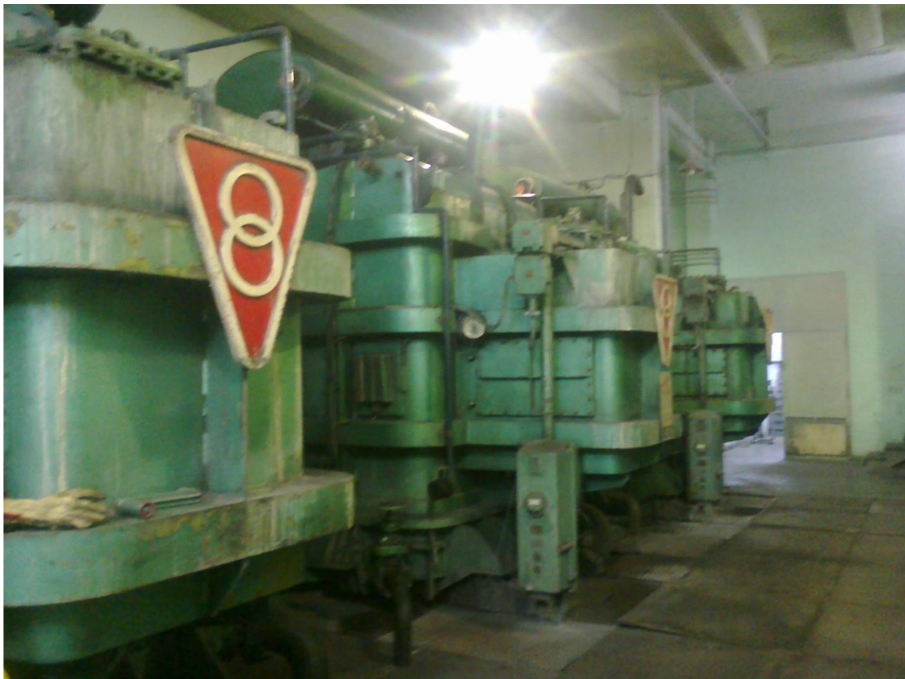
Fig. 52: Sala de transformadores monofásicos de 5MVA.
