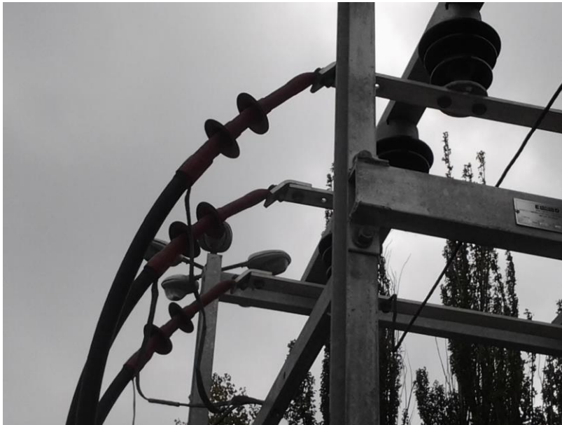
Fig. 57: Conductores de entrada a barras de banco de capacitores provisoriamente conectados sin descargador.
