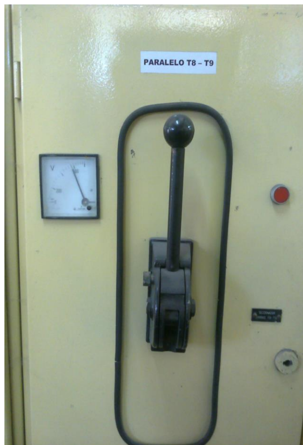
Fig 24: Paralelo entrada Trafos T8 y T9.
