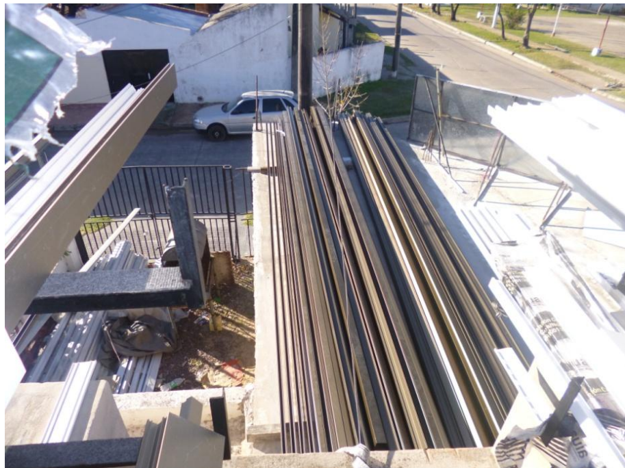
Sector de acopio de perfiles sin barandas de protección
