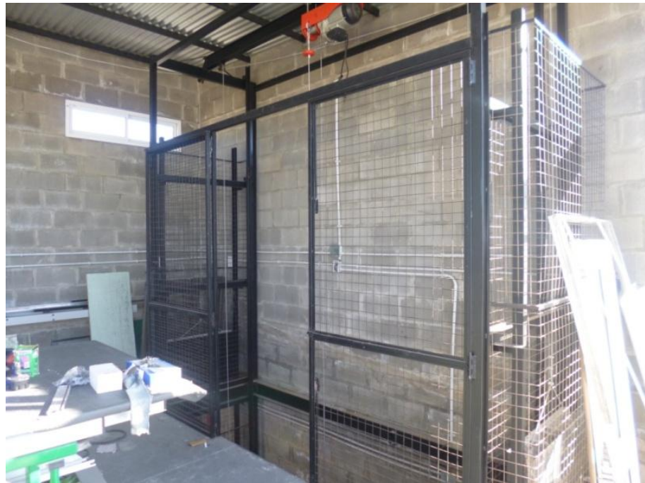
Montacargas sin barandas de seguridad cuando no está en uso
