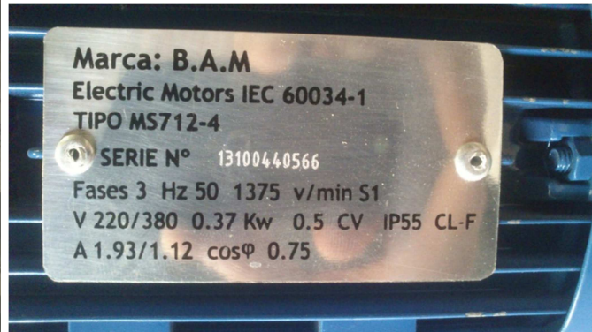
Placa de datos del motor eléctrico
