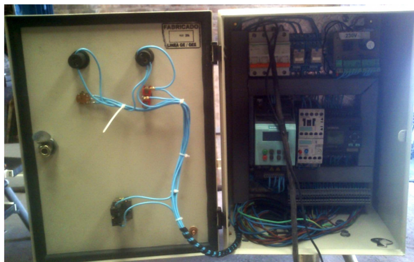
Montaje final del tablero eléctrico de la llenadora de latas
