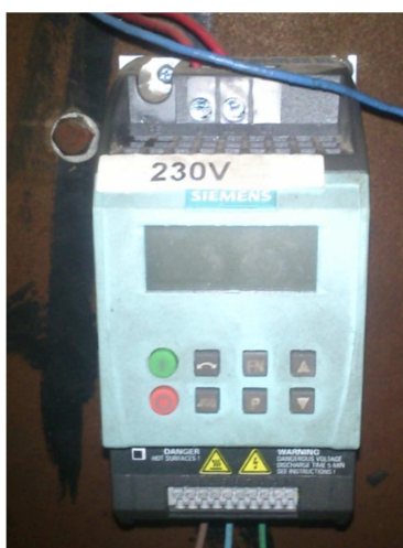
Variador de velocidad
