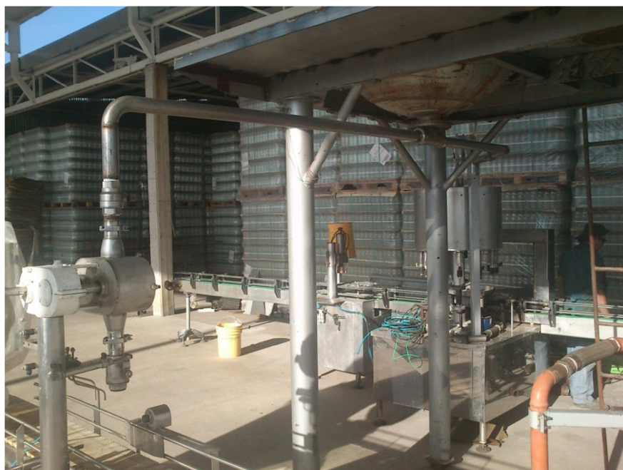
Conexión del Hot Break a las llenadoras
