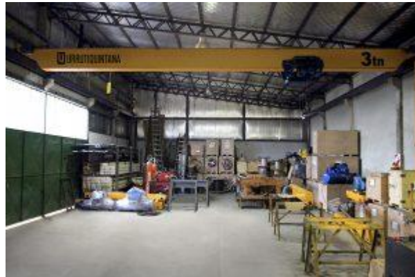
Ilustración 11: Puente grúa Urriti Quintana
