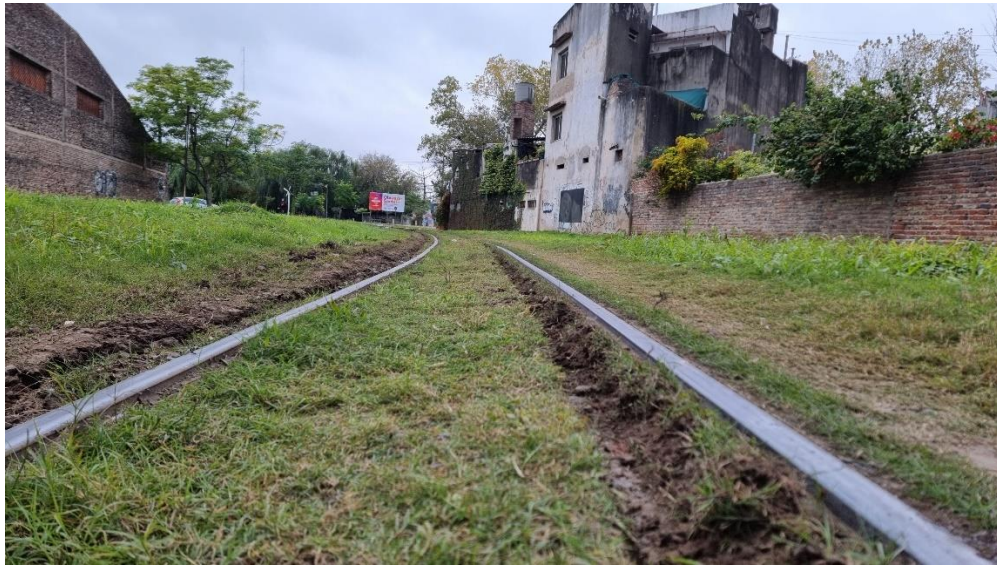
Figura 96: Peralte actual de la vía ubicada en la cercanía de calle Pedro Vittori.
