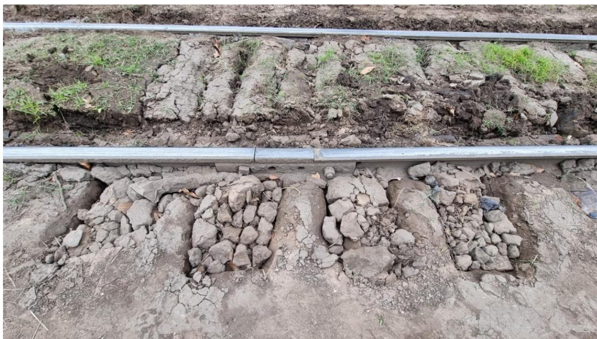
Figura 31: Durmientes de madera casi enterrados y en mal estado.
