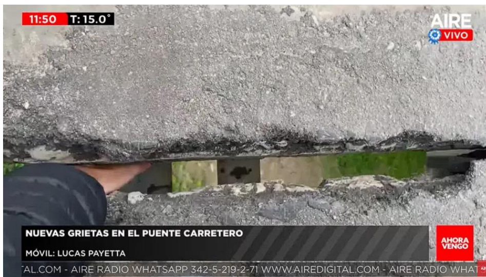
Figura 39: Nueva grieta puente carretero, fecha 21 de mayo de 2024.
