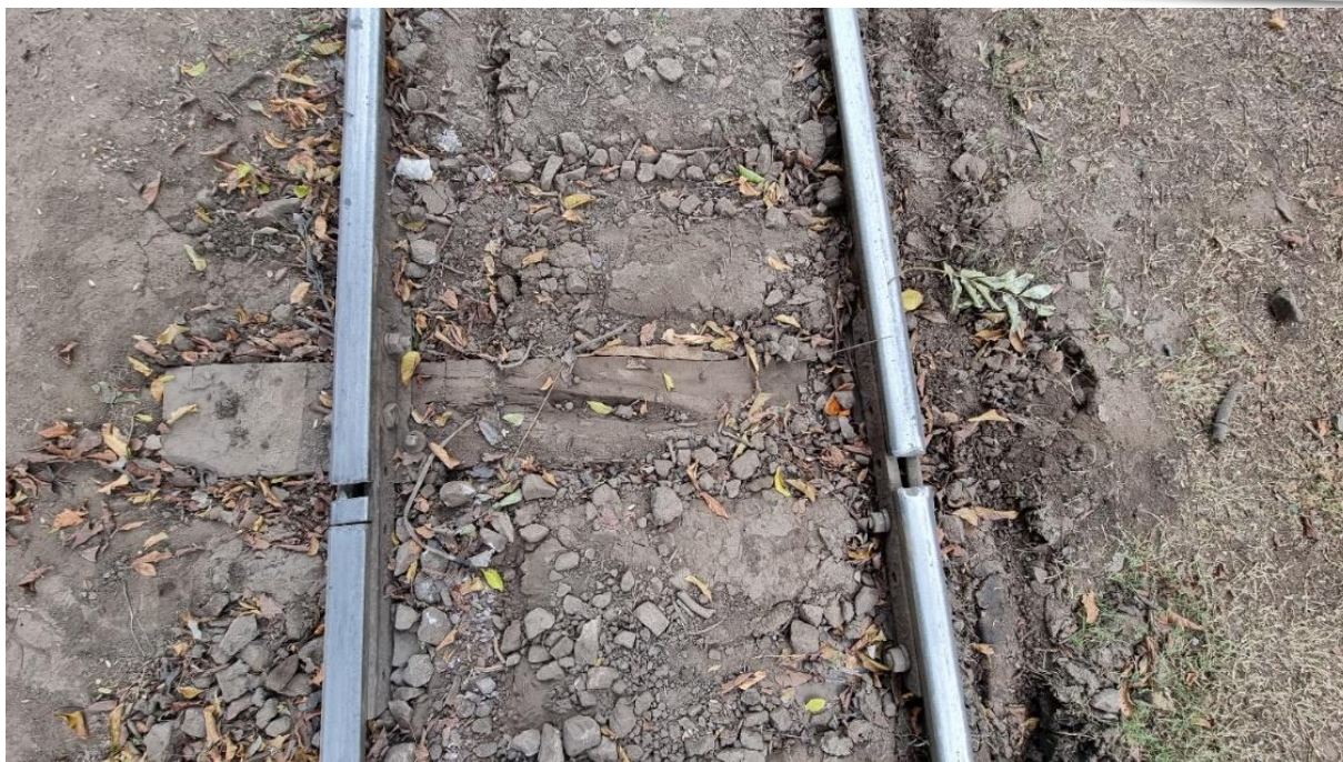
Figura 30: Durmientes de madera casi enterrados y en mal estado.
