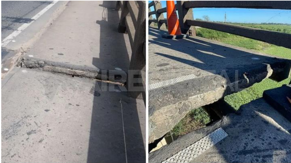
Figura 38: Grieta puente carretero, izquierda 13 de marzo de 2024 y derecha 20 de abril de 2024.
