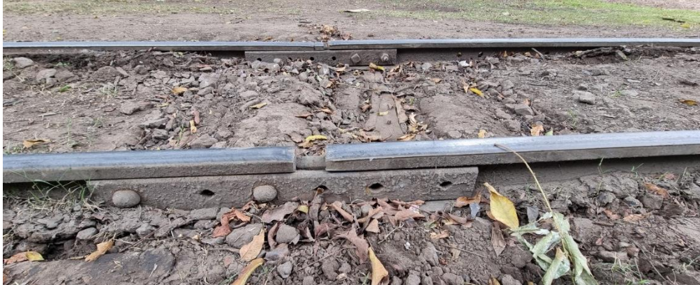
Figura 32: Uniones en mal estado.
