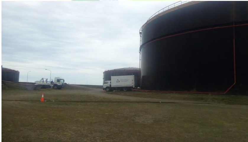
Foto 8. Se observan los tanques durante la limpieza. A la izquierda, un camión porta volquete dispone y organiza volquetes según las indicaciones del supervisor. A la derecha, un pañol móvil garantiza fácil acceso a herramientas y equipo de protección personal.
