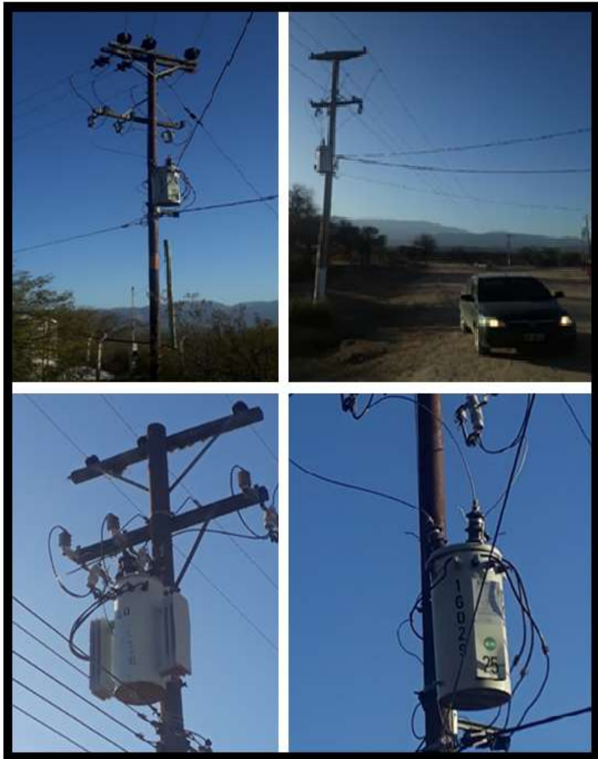
Figura 44: Subestaciones transformadoras aéreas en el Poblado de Huaco. Fotografía superior izquierda: 1° estación transformadora de 16 KVA al ingresar al Poblado de Huaco desde el extremo sur; Fotografía superior derecha: 2° estación transformadora de 25 KVA situada sobre calle principal; Fotografía inferior izquierda: 3° de estación transformadora de 40 KVA situada sobre calle principal; Fotografía inferior derecha: 4° estación transformadora de 25 KVA situada al norte del poblado. Fotografías tomadas en el mes de marzo del año 2023.
