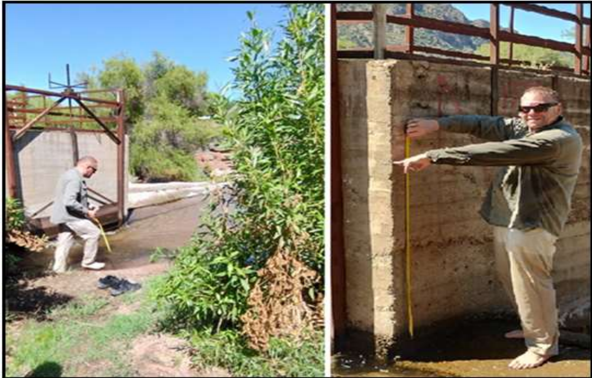
Figura N° 46: Nivel de creciente sobre el vertedero de cimacio. Determinación de la altura aparente alcanzado por el agua en la creciente del 19 y 20 de febrero en el vertedero de cimacio del Azud Paso de los Sauces.
