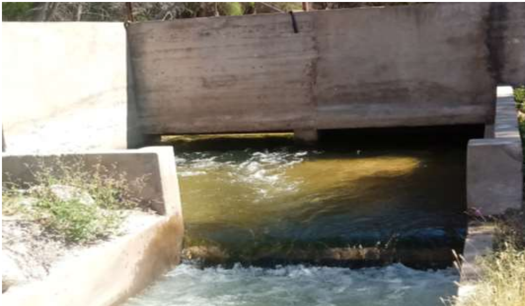
Figura 16: Vista del vertedero de medición. Existente en la toma de captación de agua en el Azud Paso de los Sauces, Río Huaco. Mes de marzo del año 2019.
