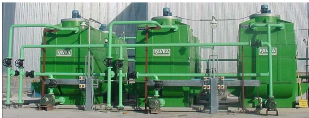
Ilustración 61: Torres de enfriamiento. Fuente: FAVRA.
