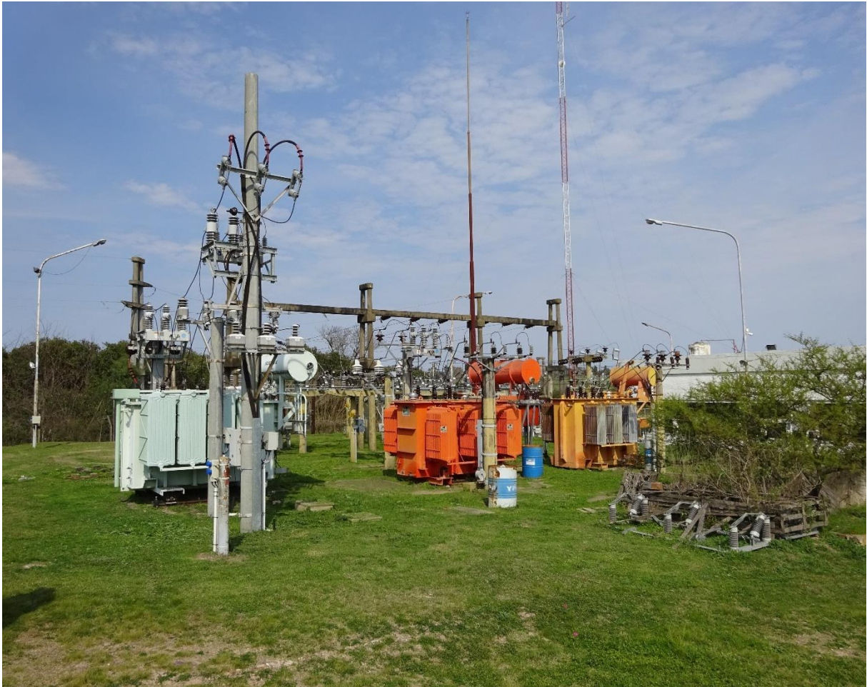
Ilustración 4 – Playa de 33kV, Campos de Transformadores SET Strobel
