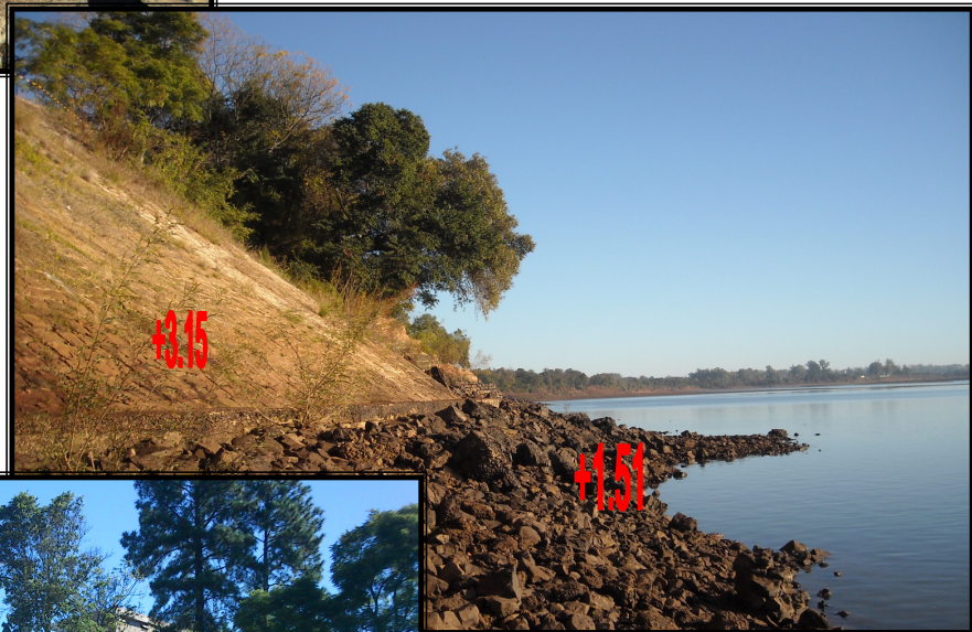
Foto 20- enrocado a pie de recubrimiento marginal, con alguna faltantes de material. (orientación de fotografía Noroeste)
