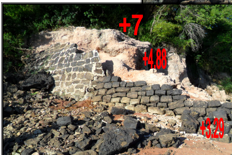
Foto 17 y 18 Material del núcleo erosionado y rotura cobertura exterior
