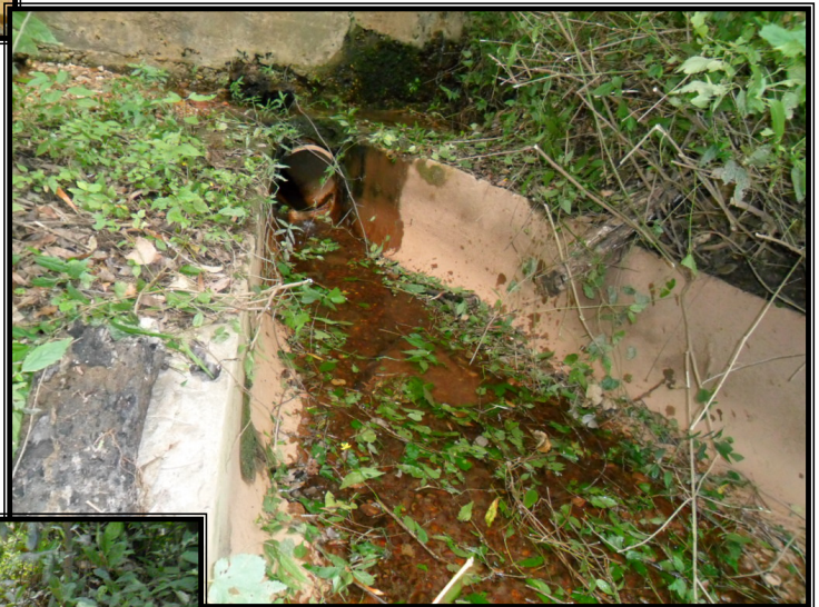
Foto 14 Vista de salida del desagüe de sedimentadores (Orientación de fotografía Sur)
