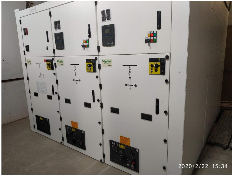
Fig. 18: Vista general – Conjunto de celdas de media tensión.
