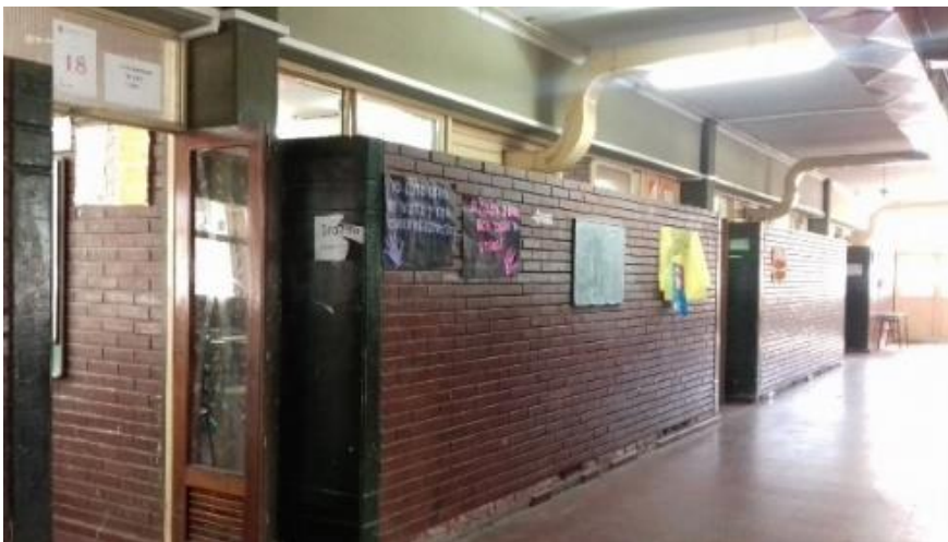
Muros (casilleros) en la dirección X causantes del efecto de columna corta
