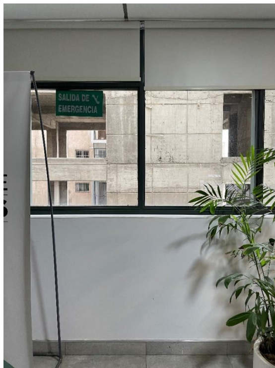
Imagen 2.11. Toma desde pasillo principal en uno de los niveles, se observan la viga de antepecho, aberturas, carpintería, viga superior y cielorraso
